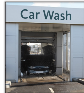
las aguas residuales de lavado de automóviles comerciales se trata
